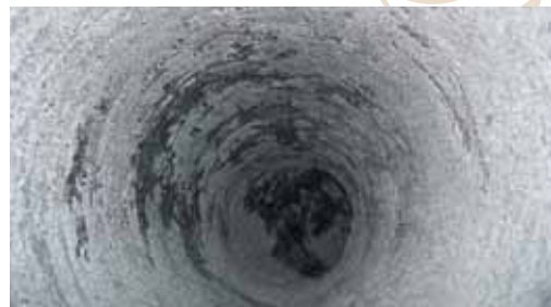
conduit encrassé par la combustion de bois humide
